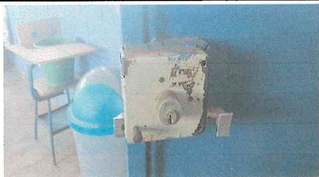
Foto 1: Chapa de la puerta de las aulas en mal estado.
