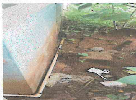
Foto 4: Tubería de red de agua potable en mal estado.
